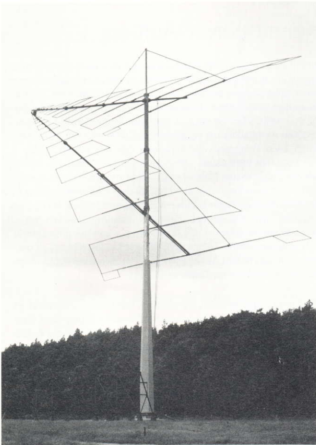
BILD 7 Drehbare logarithmisch-periodische Antennenanlage AK 226/446. Foto 10 362
